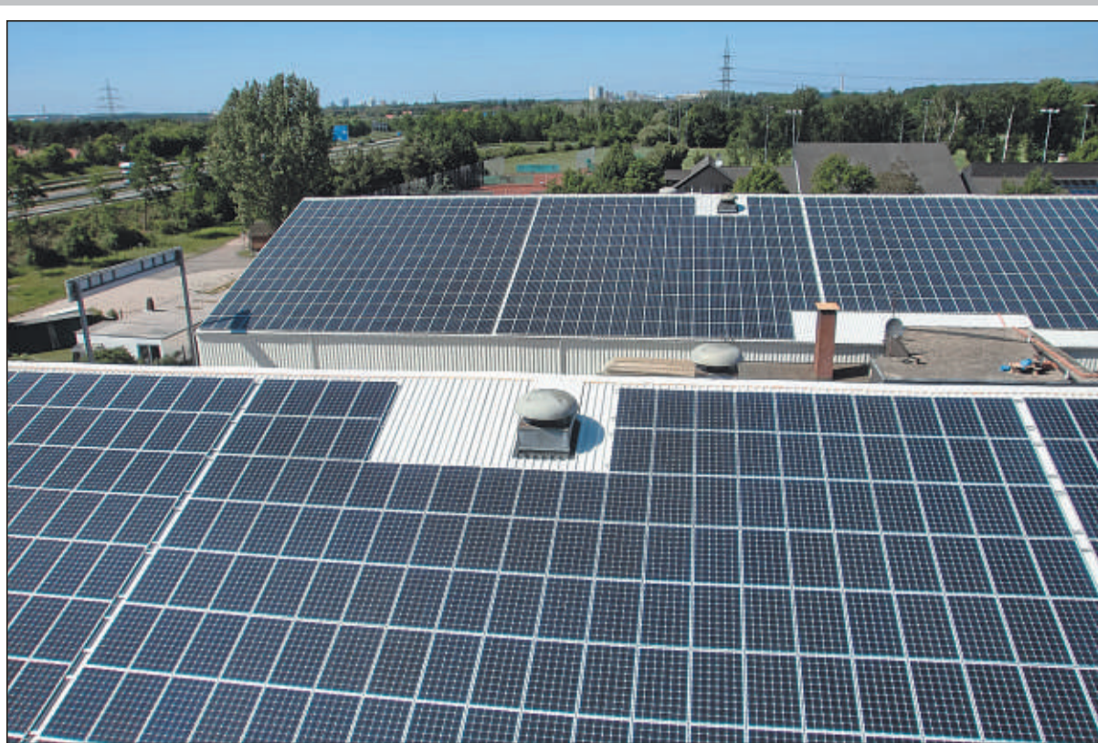
1440 Solarmodule auf zwei Dächern – das bringt Strom für rund 100 Haushalte.
